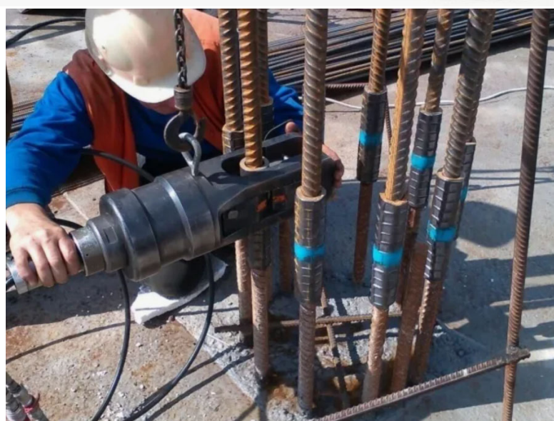
Рисунок. Оборудование для опрессовки
